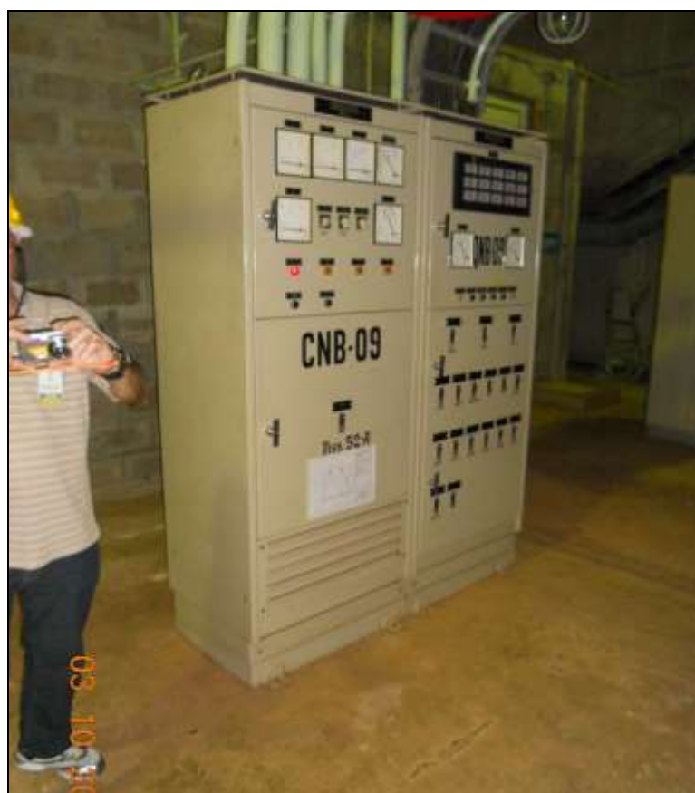
Figura 18 - Parte dos Sistemas Auxiliares de Iluminação interna e Externa da USINA HIDRELÉTRICA DE ITAIPU. FONTE: Frizanco (2014).
