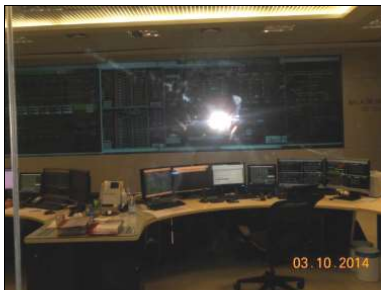
Figura 22 - Central de Operações e Controle da USINA HIDRELÉTRICA DE ITAIPU. FONTE: Frizanco (2014).
