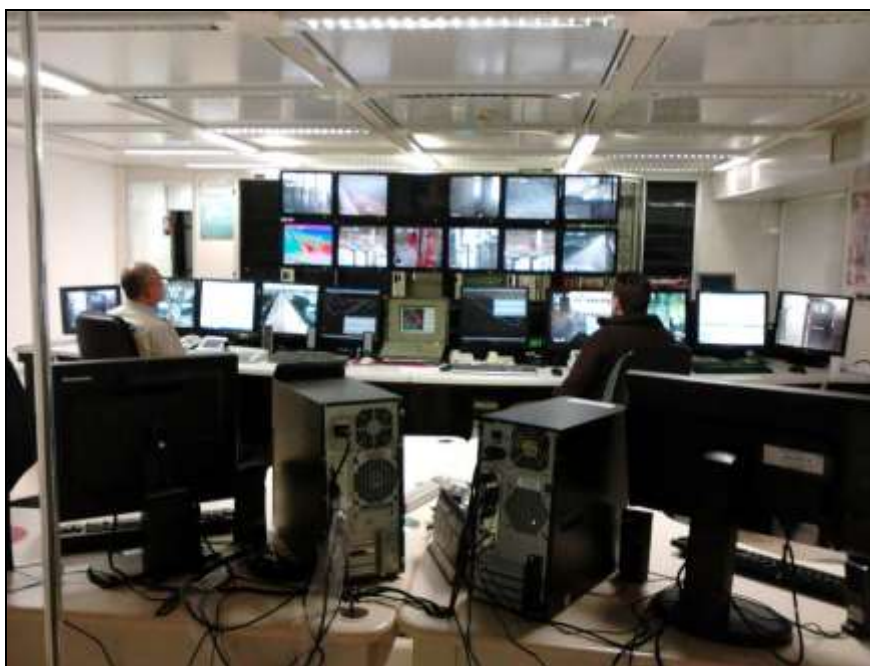
Figura 24 - Parte da central de controle de radares e câmaras de segurança FONTE: Frizanco (2014).
