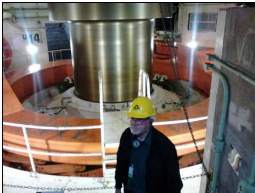
Figura 26 – Eixo da Turbina 13 em funcionamento. FONTE: Frizanco (2014).
