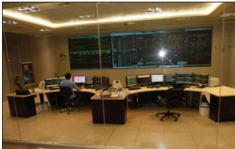
Figura 21 - Central de Operações e Controle da USINA HIDRELÉTRICA DE ITAIPU. FONTE: Frizanco (2014).
